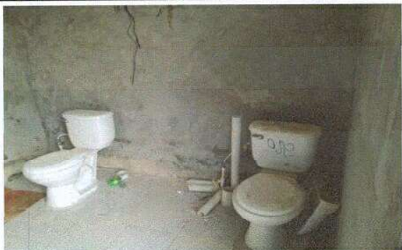
Foto 7: Servicios sanitarios y sus accesorios
